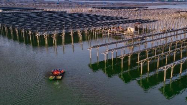
江苏 200MW 渔光互补光伏电站
