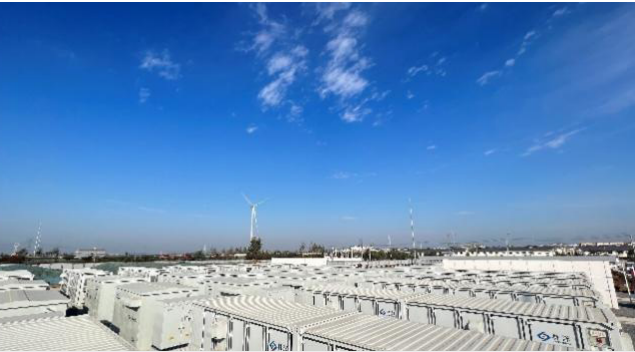
安徽 100MW/200MWh 储能基地
